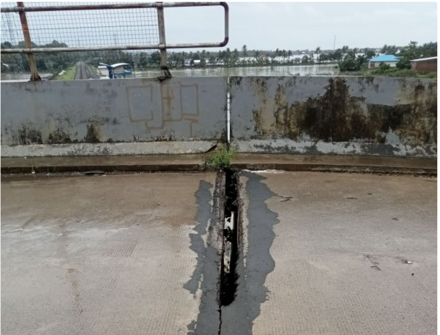
Sambungan jalan fly over Pekkae rusak parah
